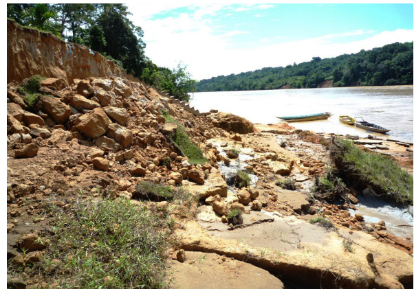
写真5 写真4の水が引いた後の様子 粘土質の河岸の崩壊物が残っている。
