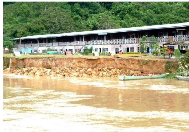
写真4 垂直崖前面で河岸の崩壊 住民への聞き取りによれば、洪水時にエクスプレスボートの波が当たって河岸が崩壊したという。
