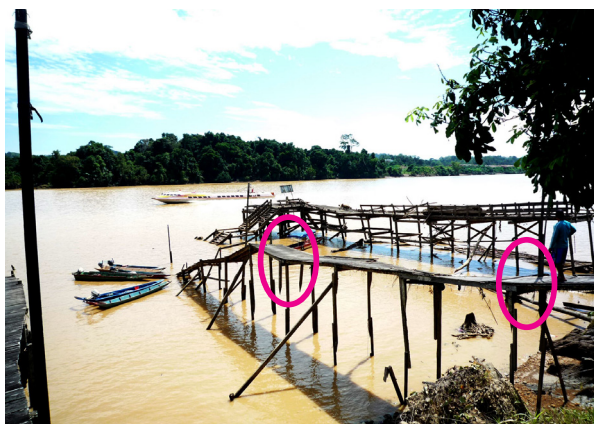
写真7 現在の栈橋に以前使用していた短い杭が残っている。赤丸内に短い杭を見ることができる。この短い杭は以前の河岸に刺さっていたものであり、以前は緩やかな傾斜の河岸であったと推測できる。
