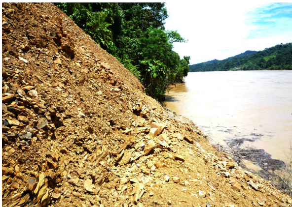
写真3 斜面崩壊の様子 砂や泥の上に基盤岩が崩れてできた礫が転がっているため足もとが不安定である。
