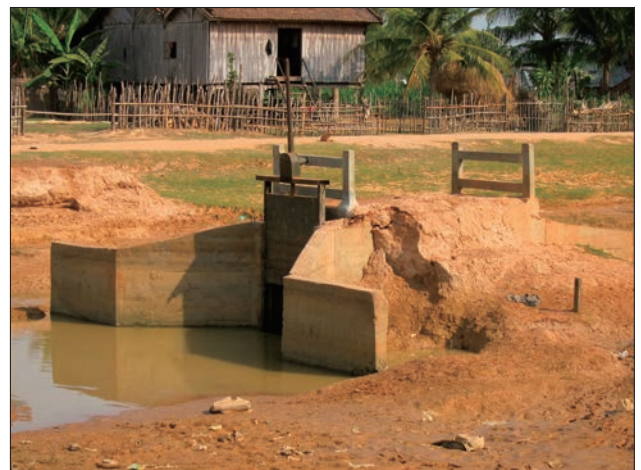
近年修復された後に再び崩壊したポル・ポト水路。水路が作られても地元住民の管理は不在であり、受益者の組織化が必要になっている。
